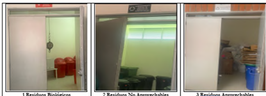
Figura 29. Condiciones del almacenamiento central de residuos sólidos en el Hospital San Joaquín - E.S.E. Salud Pereira
