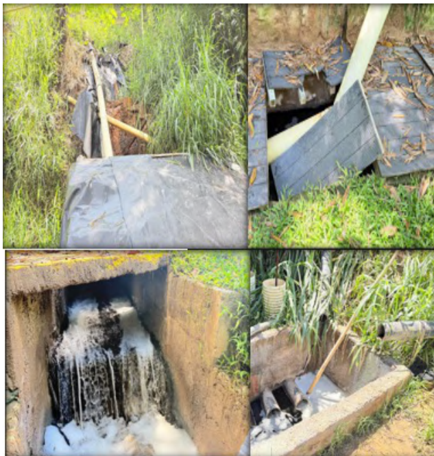
Figura 41. Canales conductores de lixiviados Relleno Sanitario La Glorita
