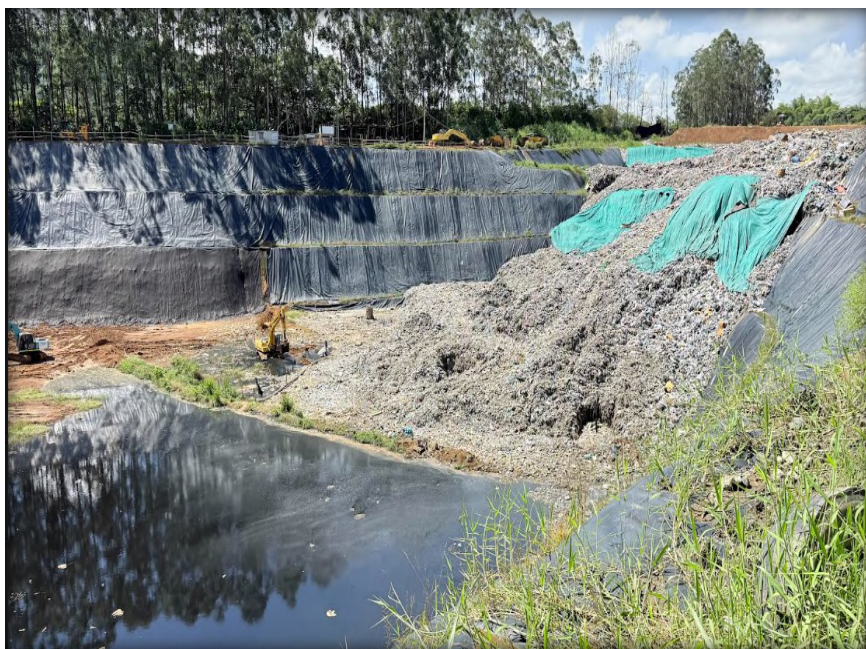
Figura 40. Acumulación de lixiviados en el vaso 9 del Relleno Sanitario La Glorita
