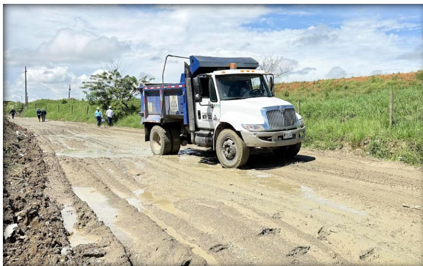
Figura 38. Estado de las vías internas del Relleno Sanitario La Glorita
